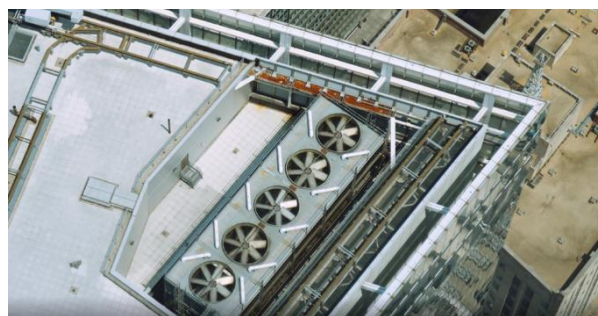
Impianti di ventilazione in copertura
