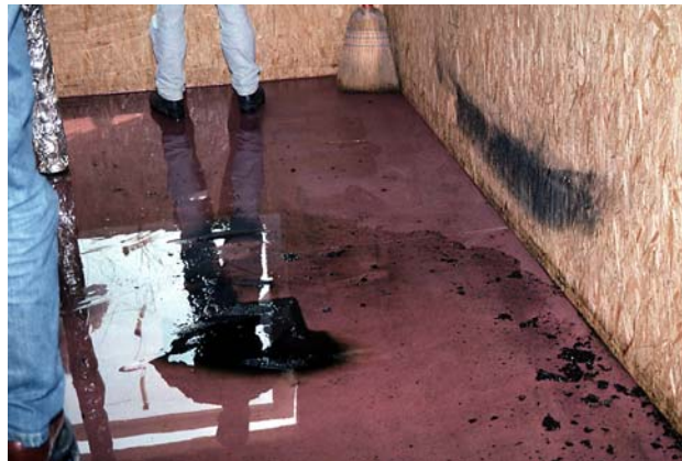
Bild 2: Dank guter Löschwirkung der Sprinkler blieb die Bausubstanz unversehrt. Die Wassermengen bleiben beim Sprinklereinsatz gering, trotzdem sollte auf eine gute Abdichtung zur Reduktion der Wasserschäden geachtet werden.
