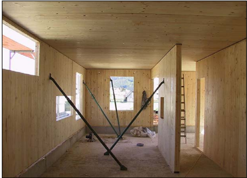
Abb. 4-6: Abstützung der Wandelemente vor und während der Montage der darüber situierten Decken- und Wandelemente
